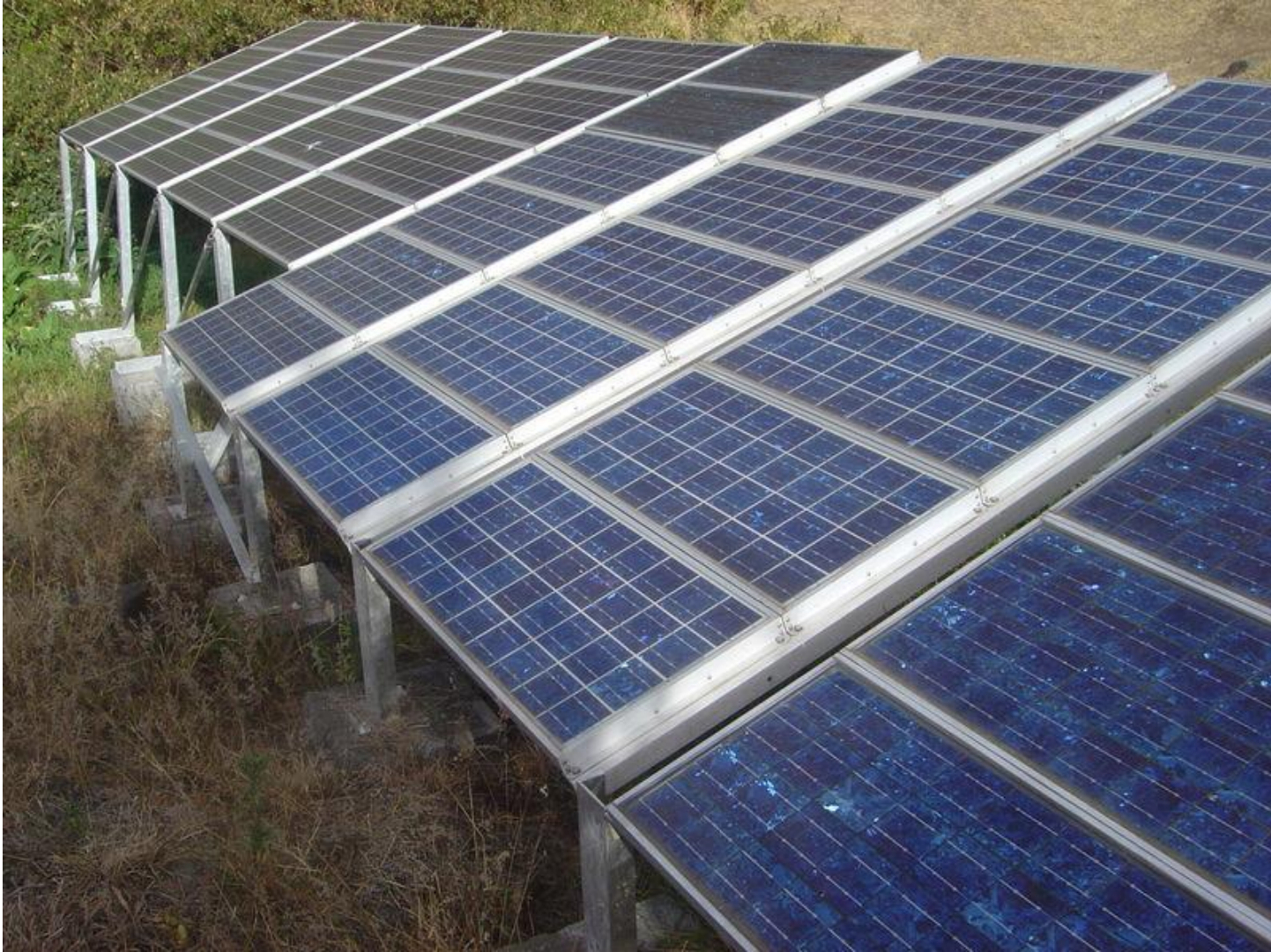
Centrale à panneaux solaires
